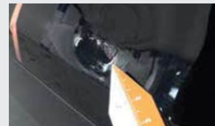
Poškodenia a trhliny
