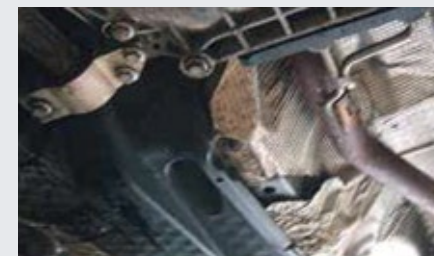
Pretrhnutý izolačný štít
