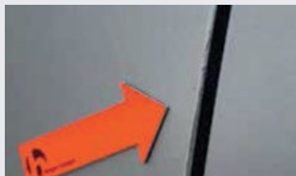
Mierne poškodenie laku na hrane dverí
